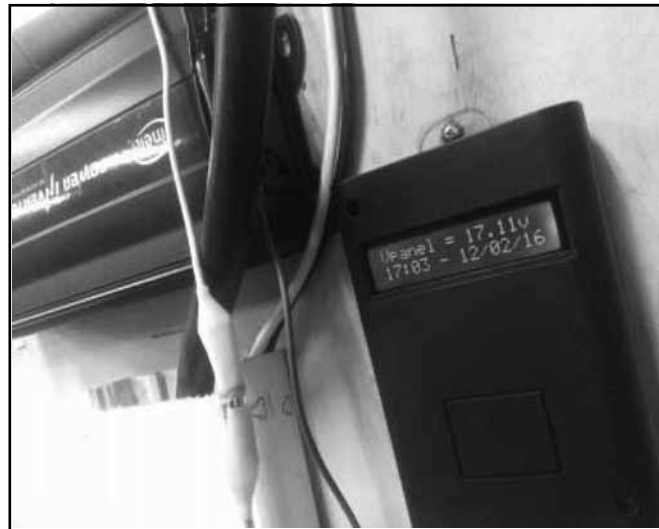
Figura 5 Detalle del prototipo de monitoreo (der.) instalado junto a la acometida del panel solar. (Se puede notar el detalle de la pantalla LCD reportando voltaje) Fuente: Propia.
