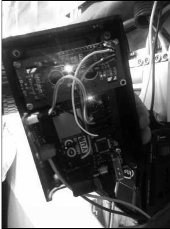
Figura 4 Detalle de la conexión de los componentes del prototipo de monitoreo Fuente: propia.
